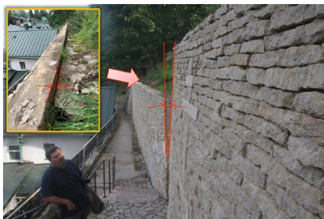
Рис. 2. Склон над пещерами хозяйственного назначения, угроза обвала обводненного грунта и частично разрушенной подпорной стены
