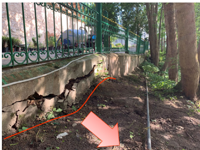
Рис. 3. Развитие оползня вблизи Тайловской башни, частичное или полное разрушение подпорных стенок
