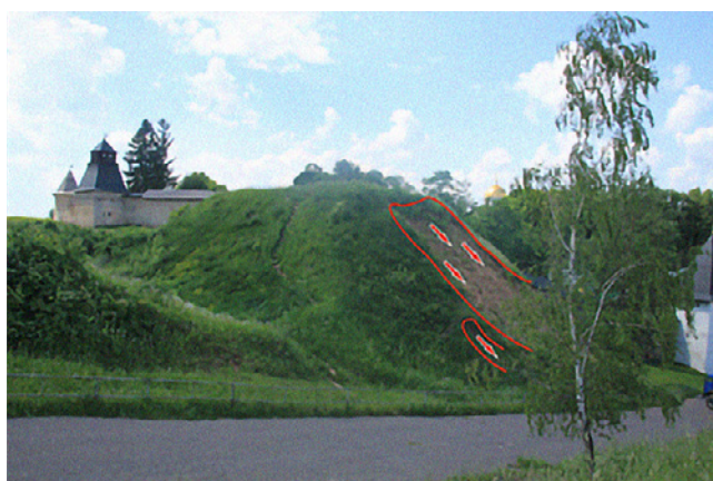
Рис. 7. Развитие оползня на склоне Петровского бастиона
