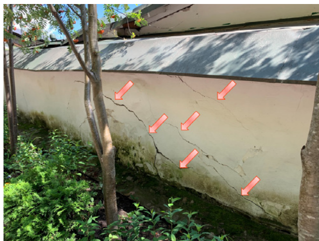
Рис. 4. Трещины в сооружениях, расположенных вдоль «Кровавой» дорожки
